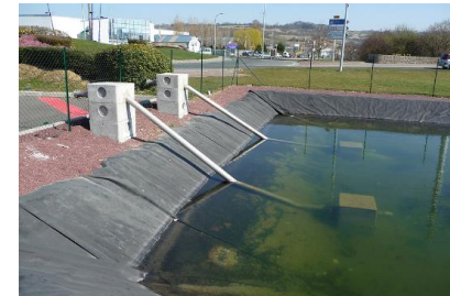
Réservoir à ciel ouvert avec colonne fixe d'aspiration
