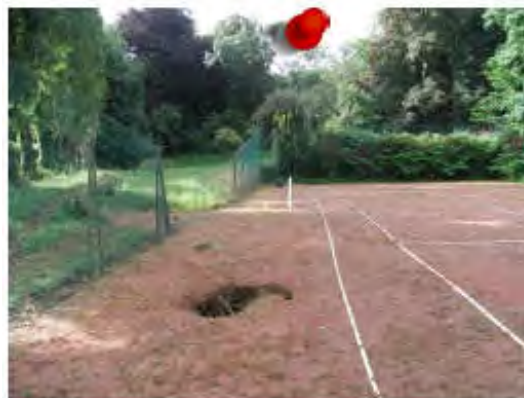
2013 - Effondrement Commune de Villars
